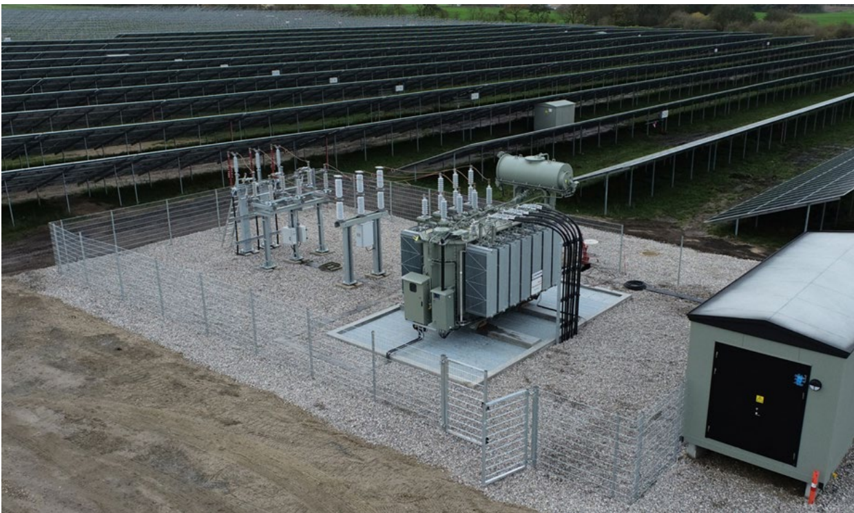
Kuva 5. Esimerkkikuva teollisen mittaluokan aurinkovoimalaitoksen muuntamoalueesta ja paneelientistä.
