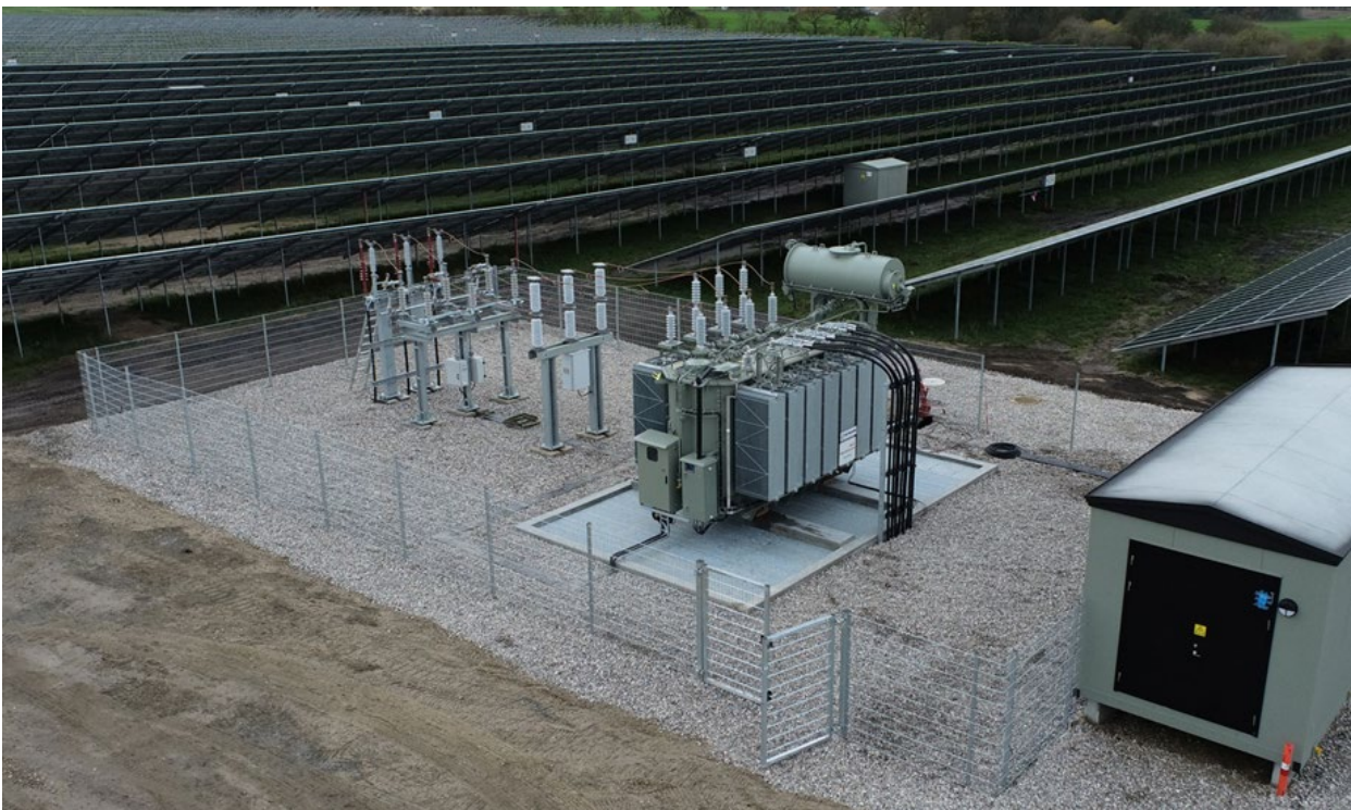
Kuva 7. Esimerkkikuva teollisen mittaluokan aurinkovoimalaitoksen muuntamoalueesta ja paneelientistä.
