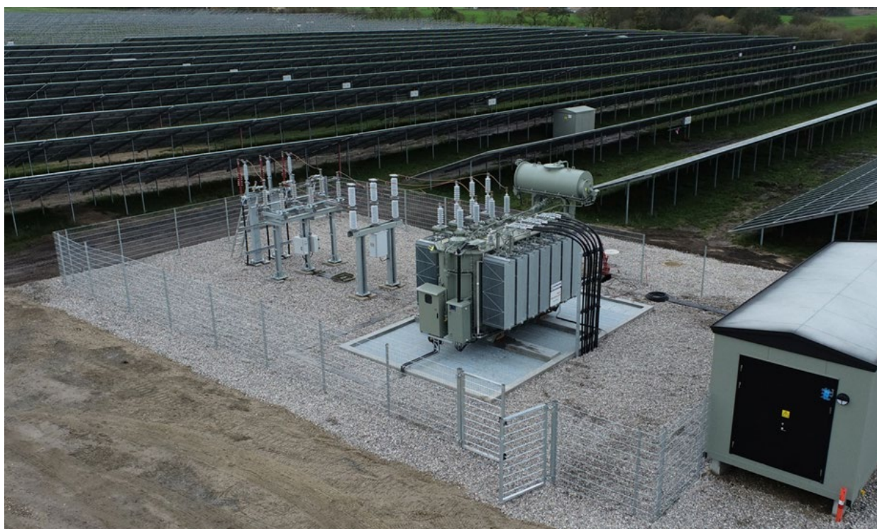
Kuva 5. Esimerkkikuva teollisen mittaluokan aurinkovoimalaitoksen muuntamoalueesta ja paneelikentistä.
